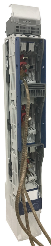
Conexión puesta a tierra Earthing device
